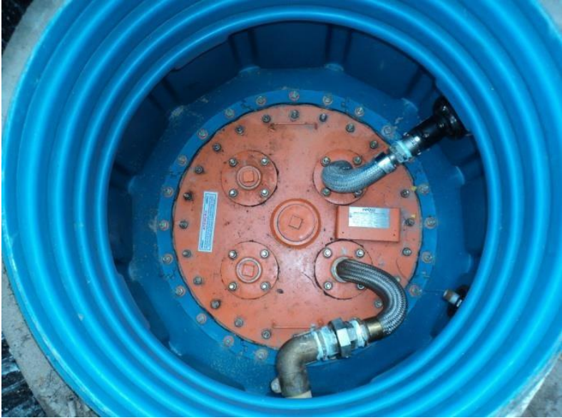
Boca de visita do tanque – Ausência do sensor medidor de
