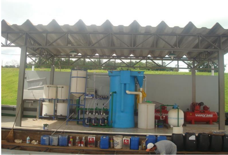
Estação de tratamento físico-químico do efluente do
