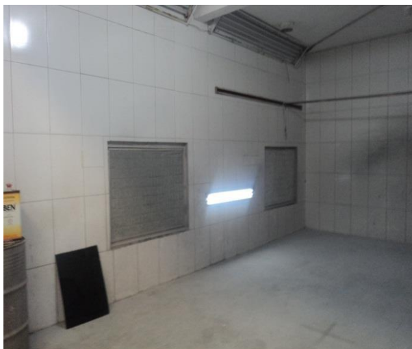
Interior da Cabine - Vista interna da cabine de pintura, contendo os
