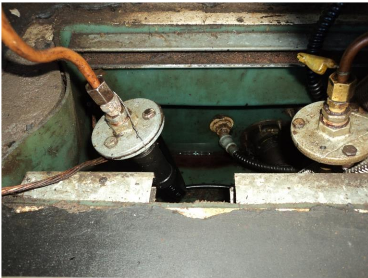
Area de abastecimento – Sump da unidade
