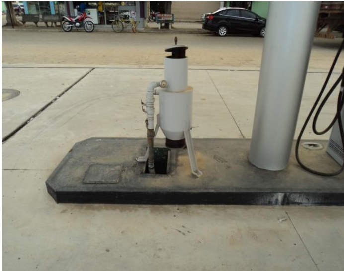
Area de abastecimento – Filtro de óleo
