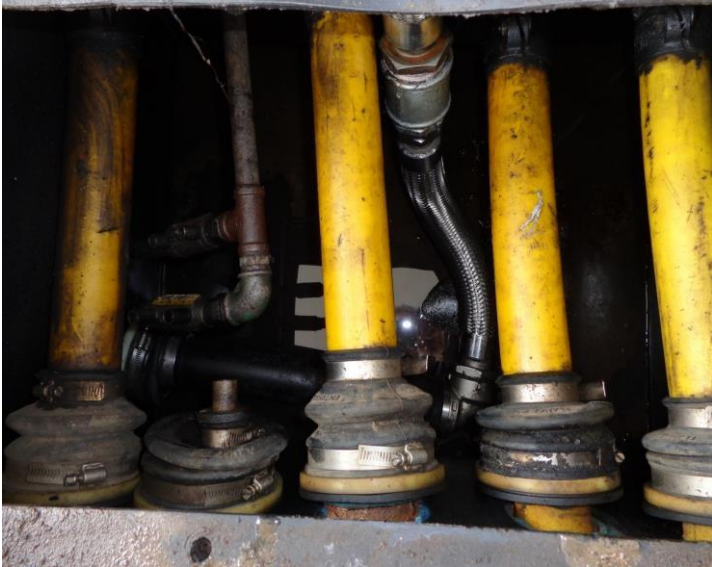
Área de abastecimento – Câmara de contenção do filtro
