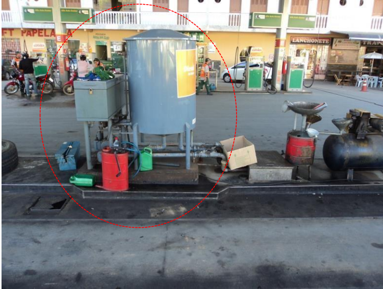
Area de abastecimento – Filtro
