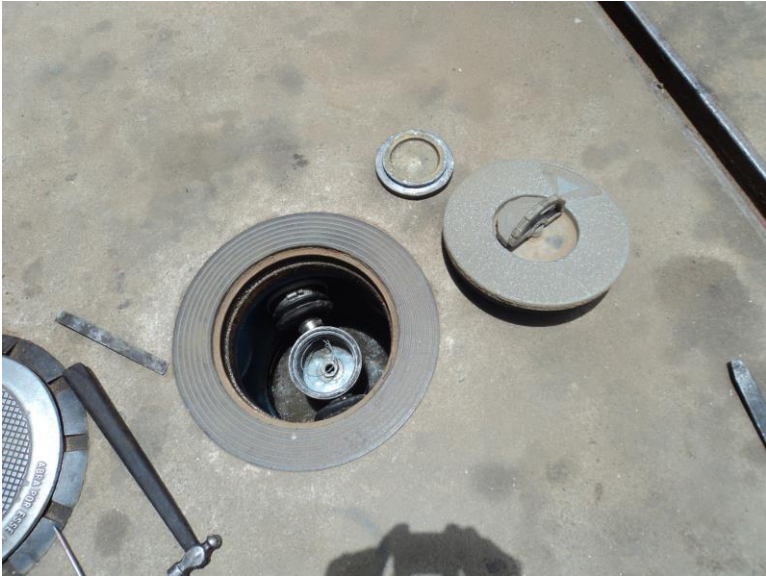
Área de descarga – Arame de espera do cabeamento do sistema de monitoramento eletrônico intersticial
