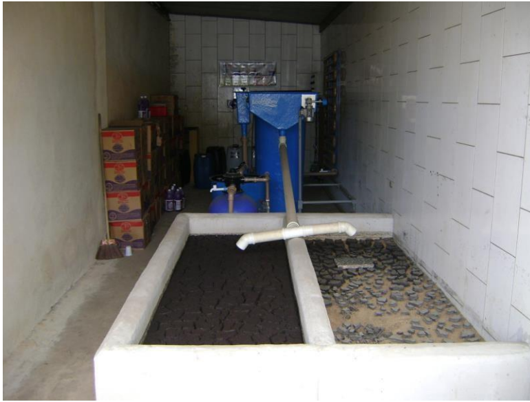
Leito de secagem da estação de tratamento físico-
