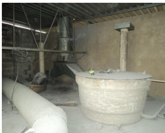
Interior da Cabine - Parte do sistema de tratamento da cabine de
