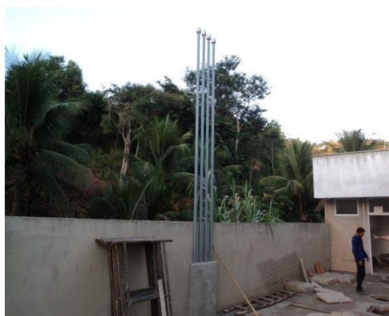
Respiros de tanques – local de instalação de válvula de
