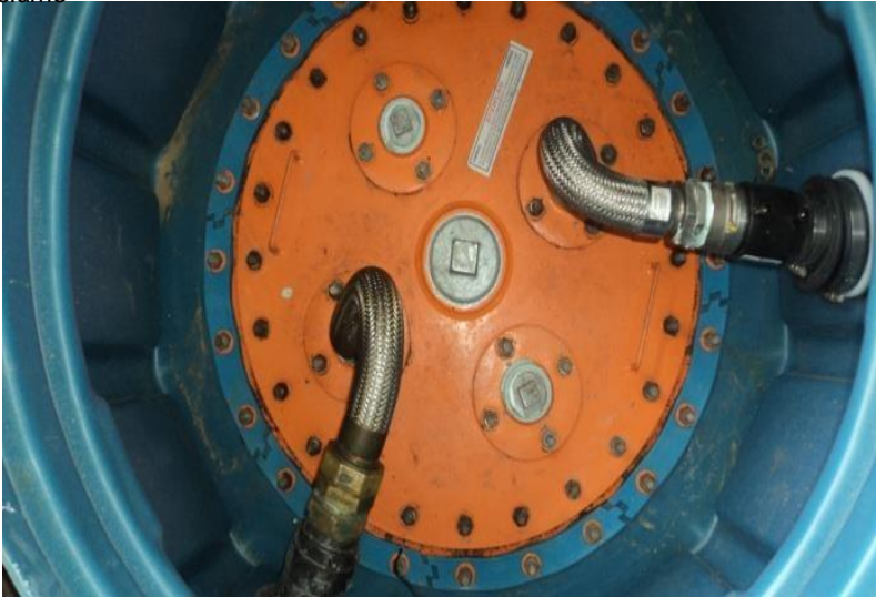
Boca do tanque - Ausência de plaqueta de identificação e sensor medidor de volume
