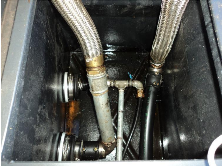
Area de abastecimento – Câmara (Sump) da unidade
