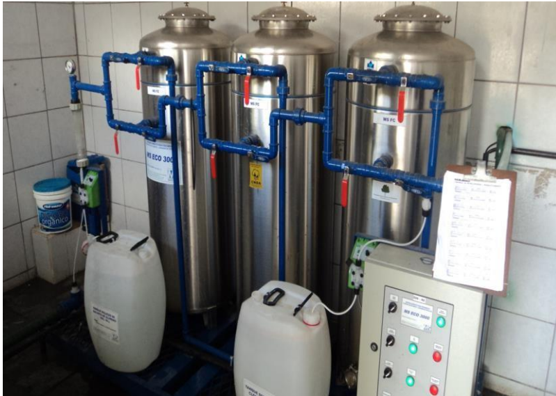
Estação de tratamento físico-
