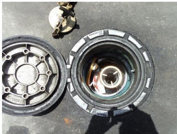
Bocal de descarga selada de combustível e local de instalação de válvula antitransbordamento
