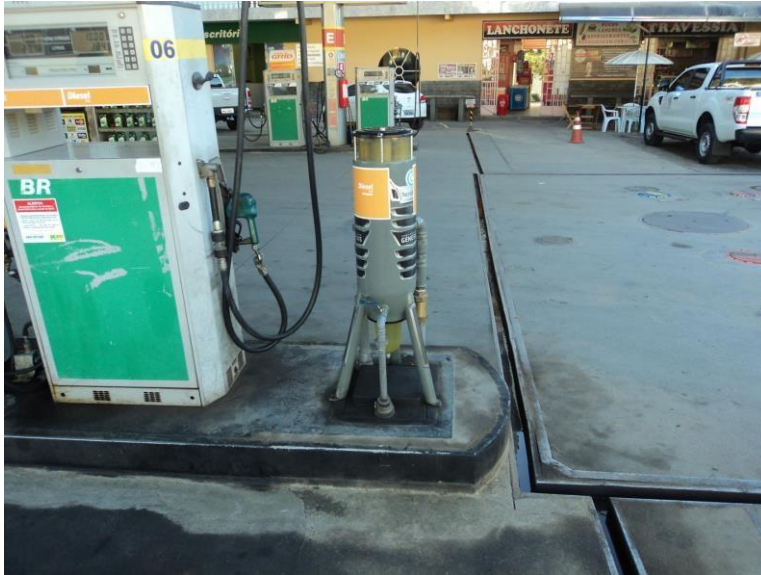
Area de abastecimento – Filtro de óleo
