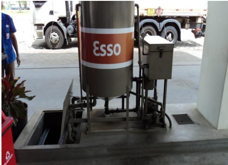
Area de abastecimento – Filtro
