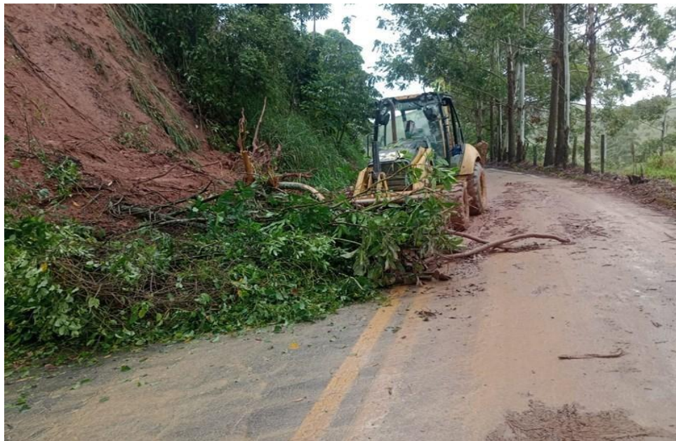
Figura 07 – Trecho que vai da BR-101 a Mimoso do Sul, há interdição parcial com funcionamento em meia pista.
