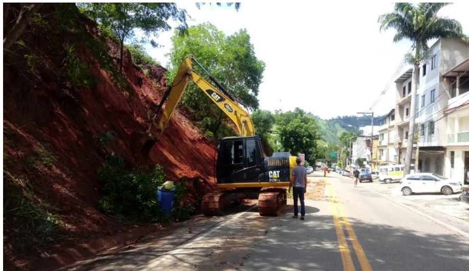
Figura 06 – Maquinários na retirada de materiais provenientes de deslizamentos de encostas
