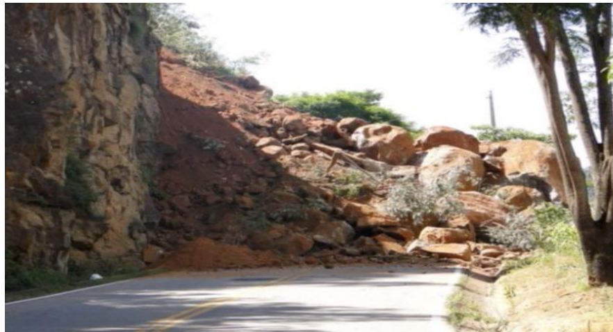
Figura 02 – Santa Leopoldina Pedras e terra tomaram pistas da rodovia ES-080
