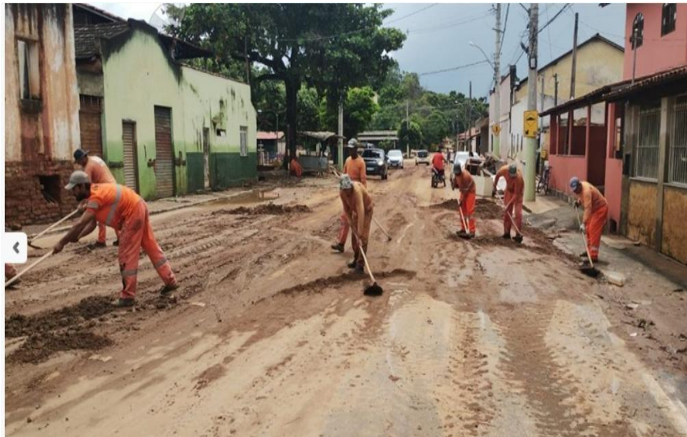
Figura 15 – Pontos críticos das rodovias que necessitam de reparos devido chuvas intensas
