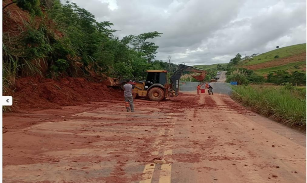
Figura 14 – Pontos críticos das rodovias que necessitam de reparos devido chuvas intensas
