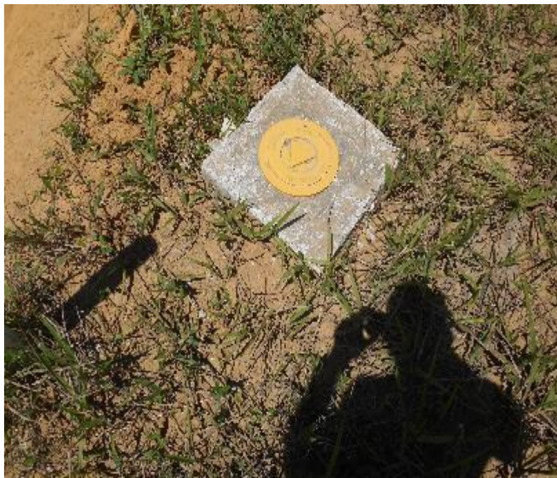
Poço de Monitoramento conforme NBR 13895
