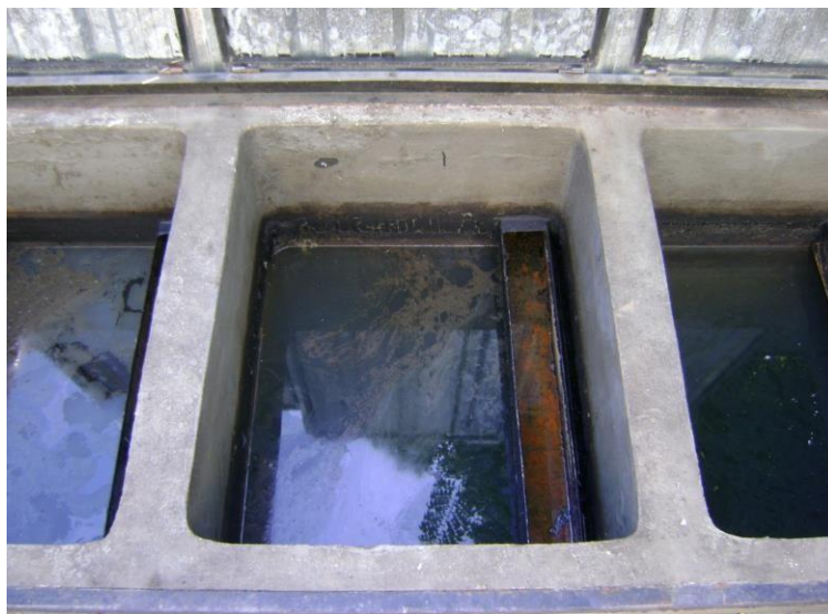
SSAO em alvenaria
