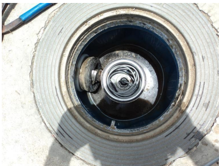
Área de descarga – Cabeamento do sensor do sistema eletrônico de monitoramento intersticial instalado
