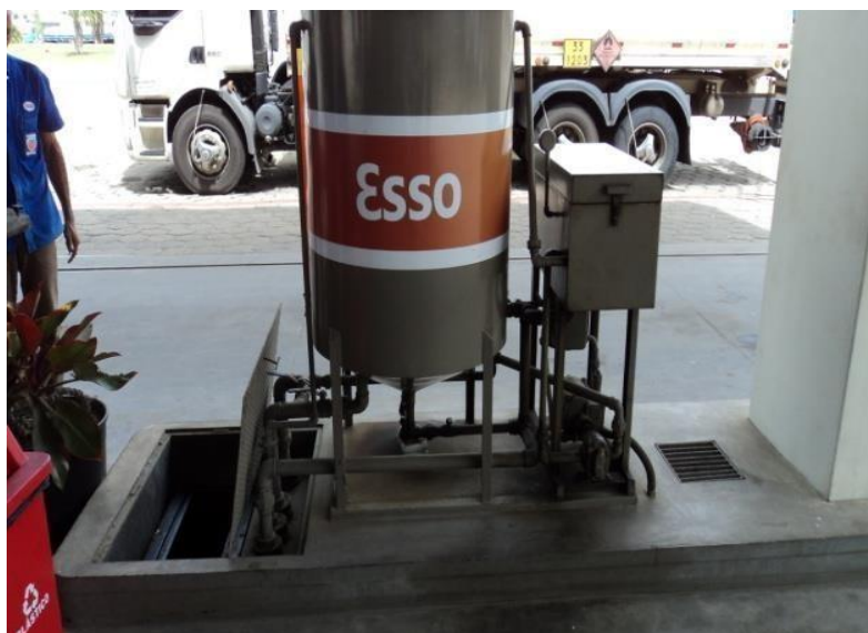
Área de abastecimento – Filtro diesel
