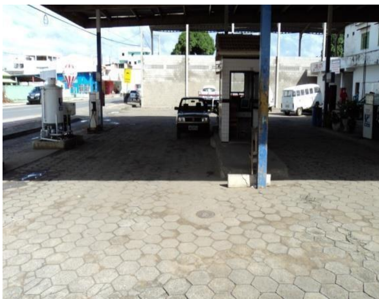
Pistas de abastecimento e descarga inadequadas
