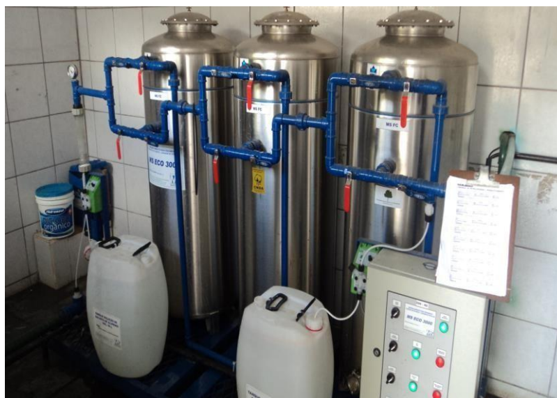
Estação de tratamento físico-químico
