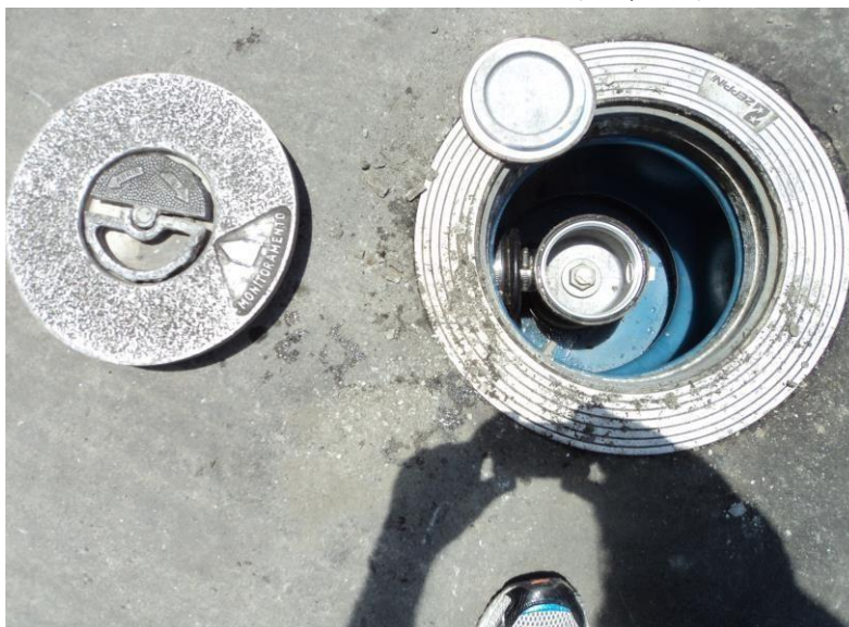
Área de descarga – Ainda a espera do cabeamento do sistema de monitoramento eletrônico intersticial (não possui)
