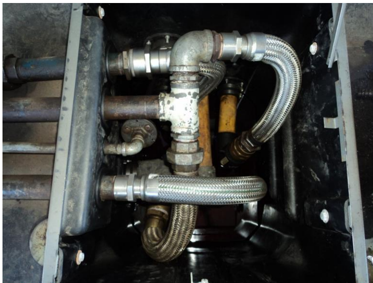
Área de abastecimento – Sump da unidade abastecedora
