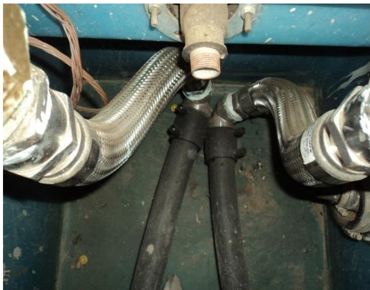
Área de abastecimento – Câmara da unidade abastecedora
