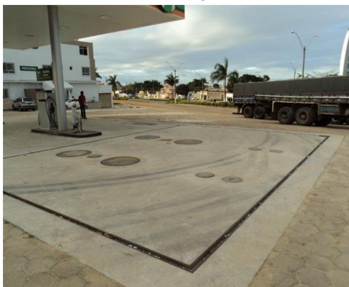
Área de descarga
