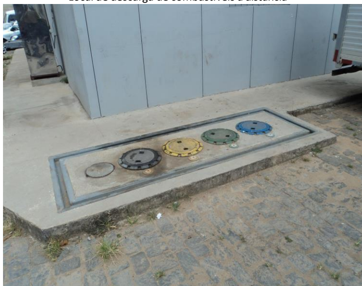
Local de descarga de combustíveis à distância
