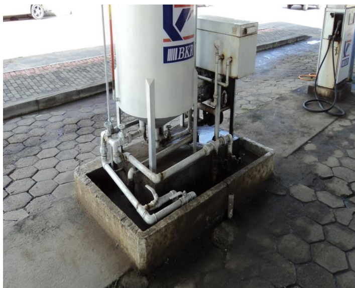
Filtro de óleo diesel inadequado
