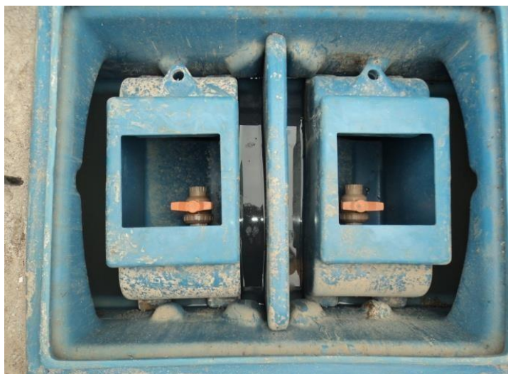
SSAO modular da pista de abastecimento e descarga de combustíveis
