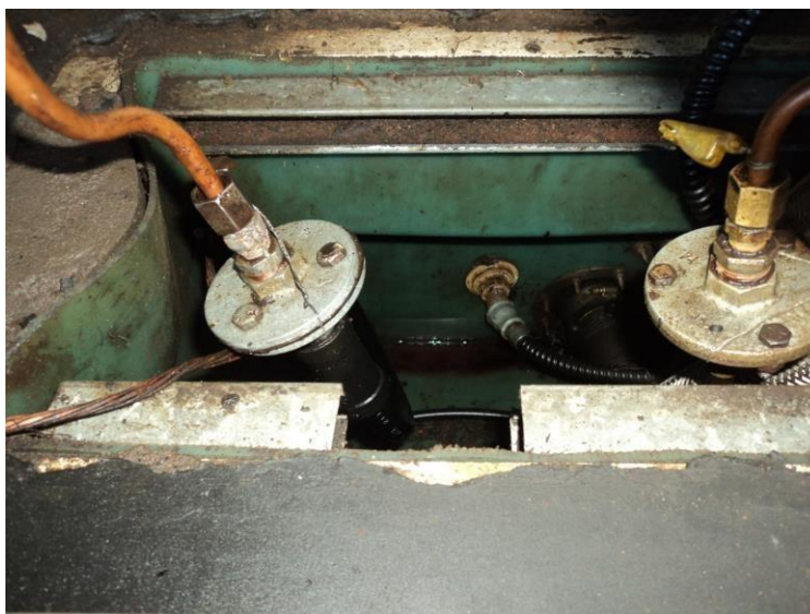
Área de abastecimento – Sump da unidade abastecedora
