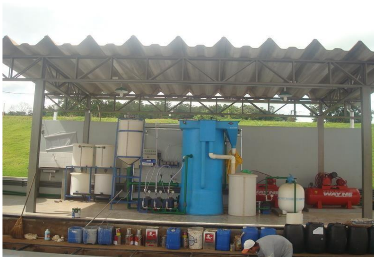
Estação de tratamento físico-químico do efluente do lavador
