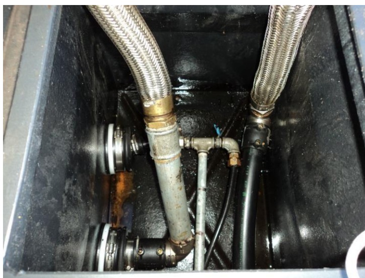
Área de abastecimento – Câmara ( Sump ) da unidade abastecedora
