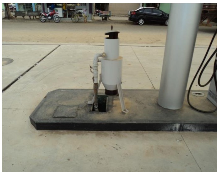
Área de abastecimento – Filtro de óleo diesel
