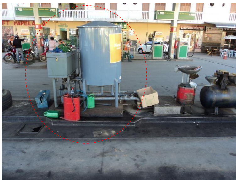
Área de abastecimento – Filtro diesel
