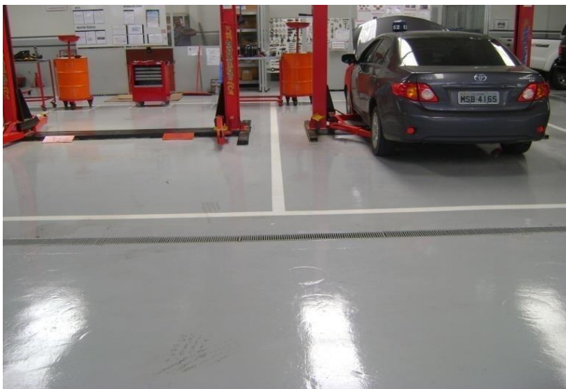
Elevador hidráulico – Área seca
