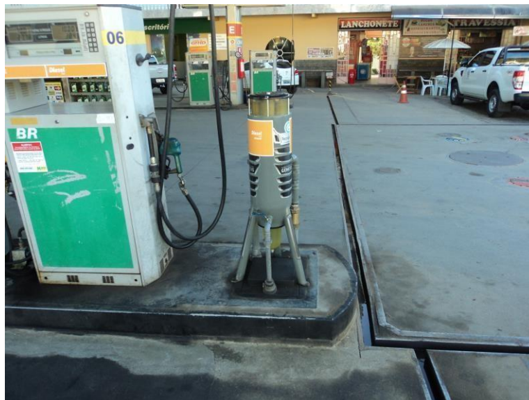
Área de abastecimento – Filtro de óleo diesel
