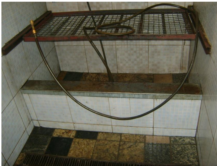
Lavador de peças – piso elevado
